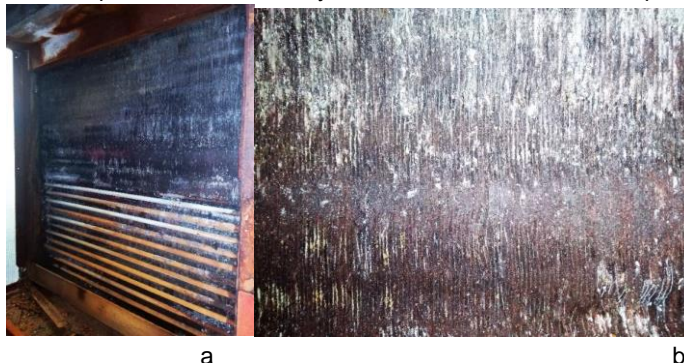
Рисунок 1. Загальний вигляд охолоджувача забортного повітря суднової системи центрального кондиціонування: а – вигляд теплообмінника зі сторони входу забортного повітря; б – стан поверхні теплообмінника у збільшеному вигляді
